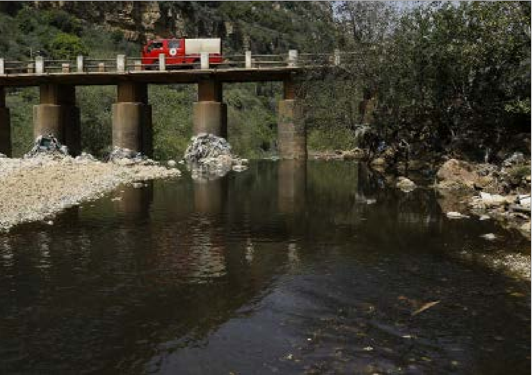
تصيف مجرى النهر يؤدي إلى انخفاضات وانزلاقات قد تعهد البنية المحاورة (مروان حطاح)
