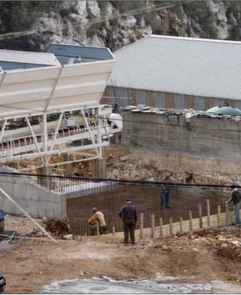
أعمال البناء عادت إلى سابق عهدها منذ صدور قرار القائم مقام (مروان بو حيدر)
